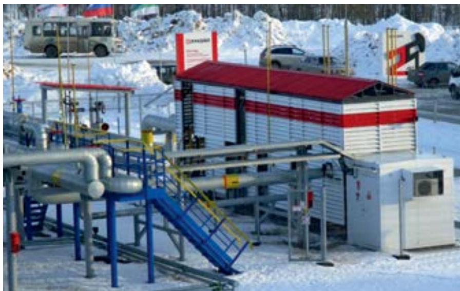
Фото 3. Блок подготовки попутного газа «ЭНЕРГАЗ»
