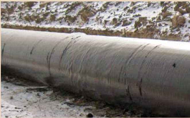
Рис. 3. Некачественное нанесение покрытия (вздутия, пазухи)
