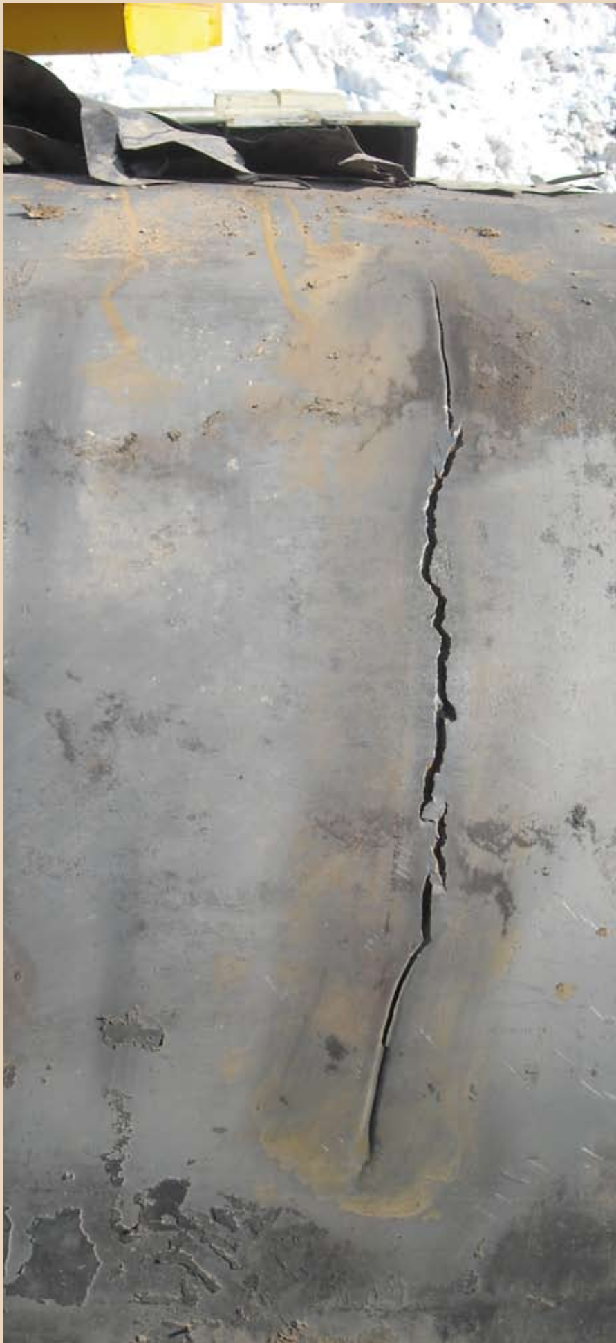
Рис. 2. Магистральная трещина поперечного КРН
